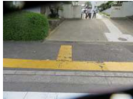
破損している点字ブロック
