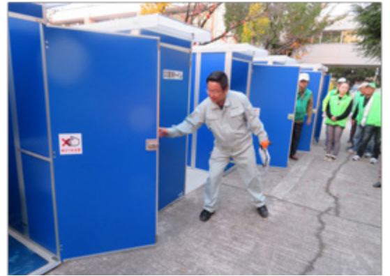
マンホール上に被せた災害用トイレ
